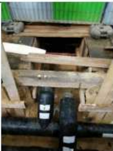
Raccordement à la sous-station centre commercial
