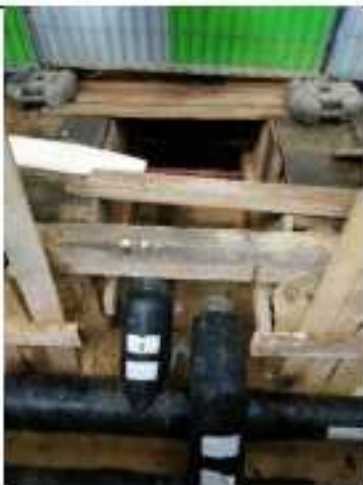
Raccordement à la sous-station centre commercial
